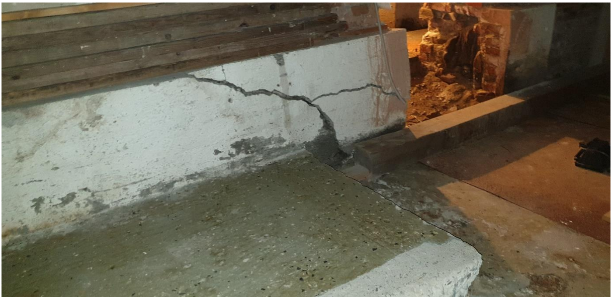
Figur 17 Sättningsskada i källaren.
