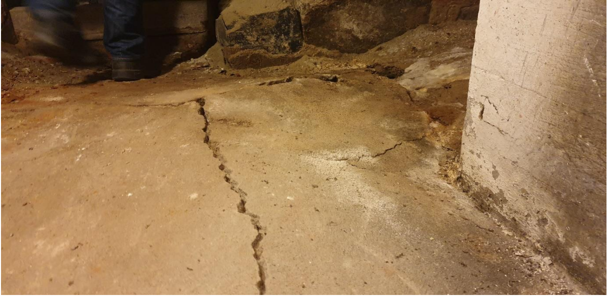
Figur 18 Skadat bjälklag i källaren.
